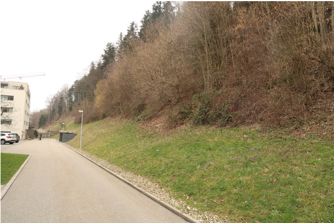
Foto 2: Böschung aus südlicher Richtung. Stellenweise können durch Abschürfen zusätzlich offene Bodenstellen gefördert werden.
